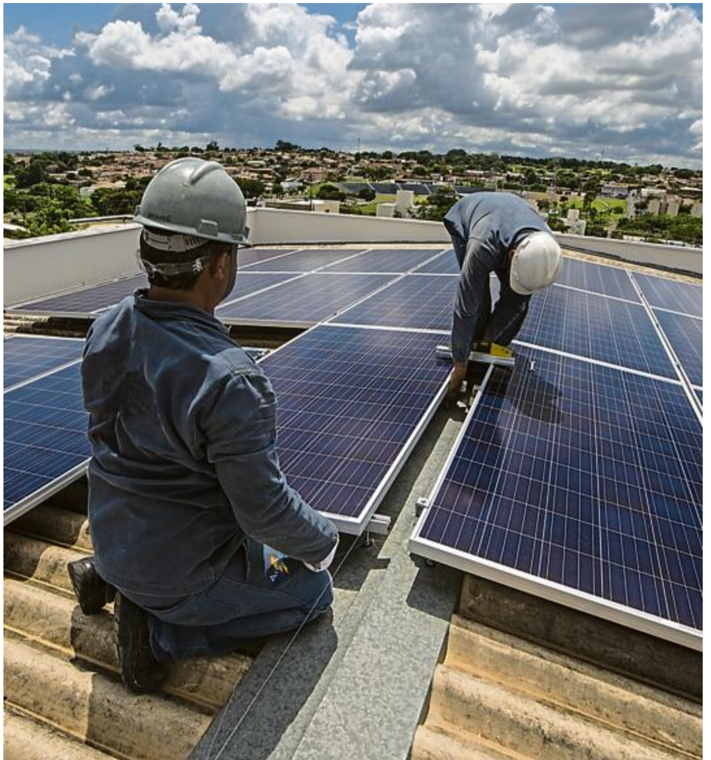
La loi Pacte permettra de faire jouer une synergie entre toitures photovoltaïques de plusieurs bâtiments là où un même quartier pouvait être scindé par des réseaux différents. Photo shutterstock
